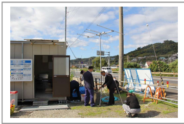
海南市下津町での FM 放送設備設置 (近畿総合通信局)
